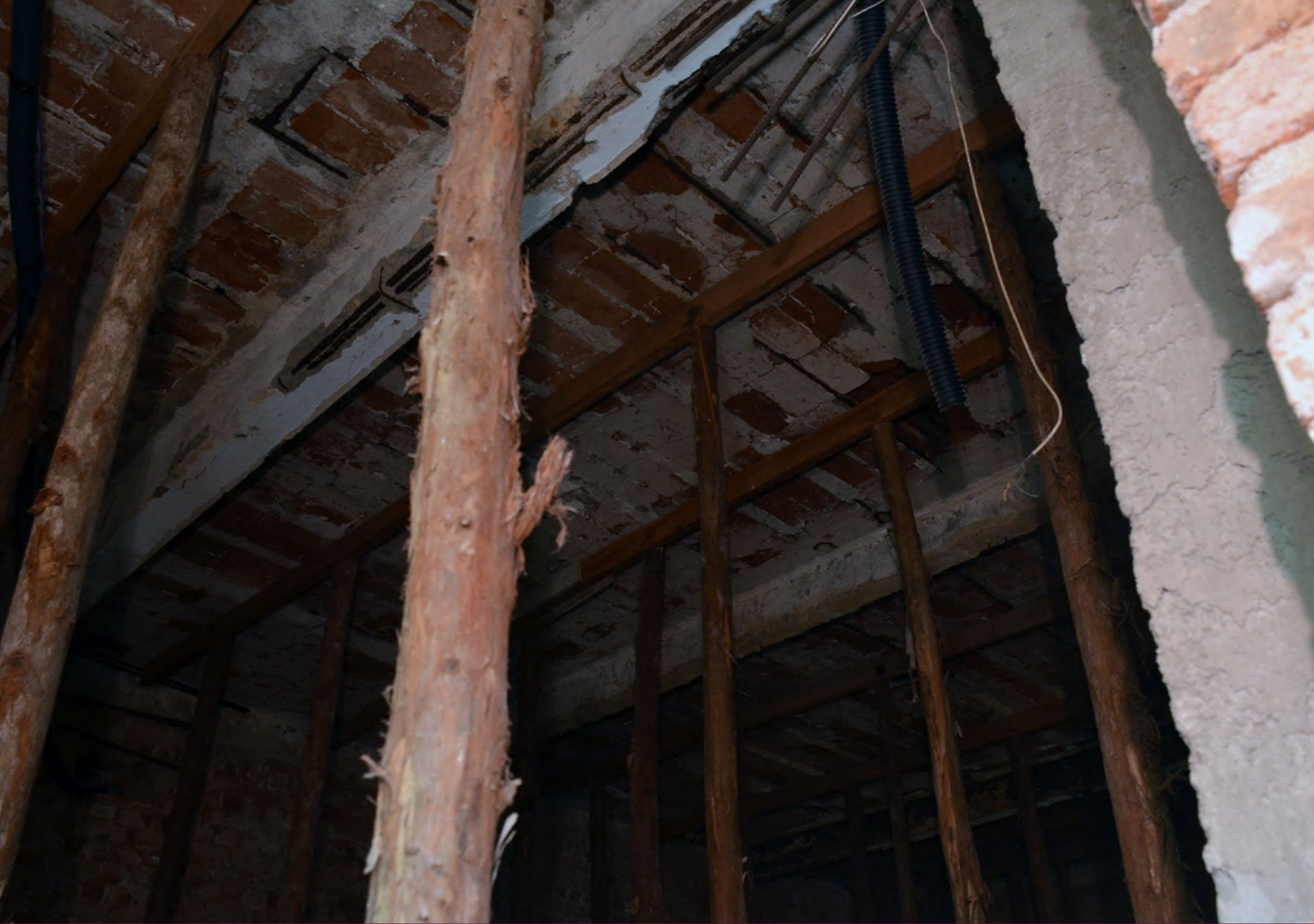
Sala com Necessidade de Reforço Estrutural
