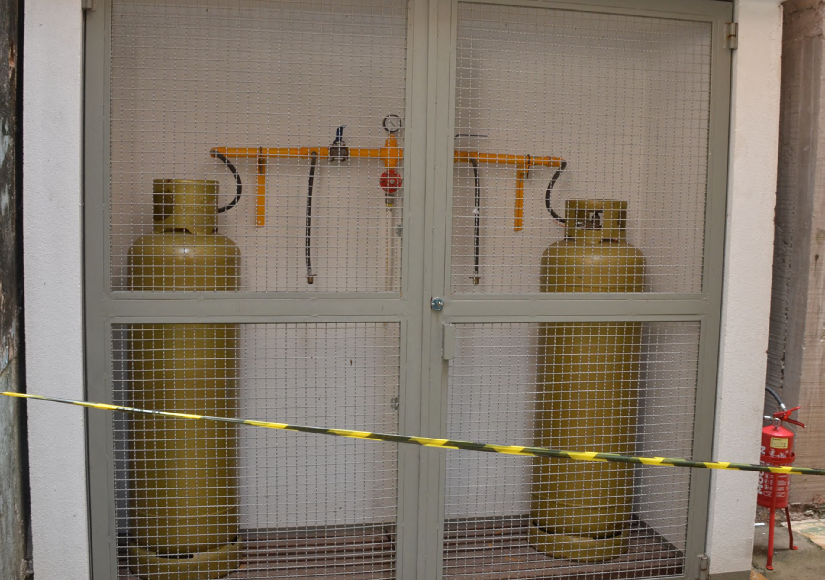
Central de Gás
