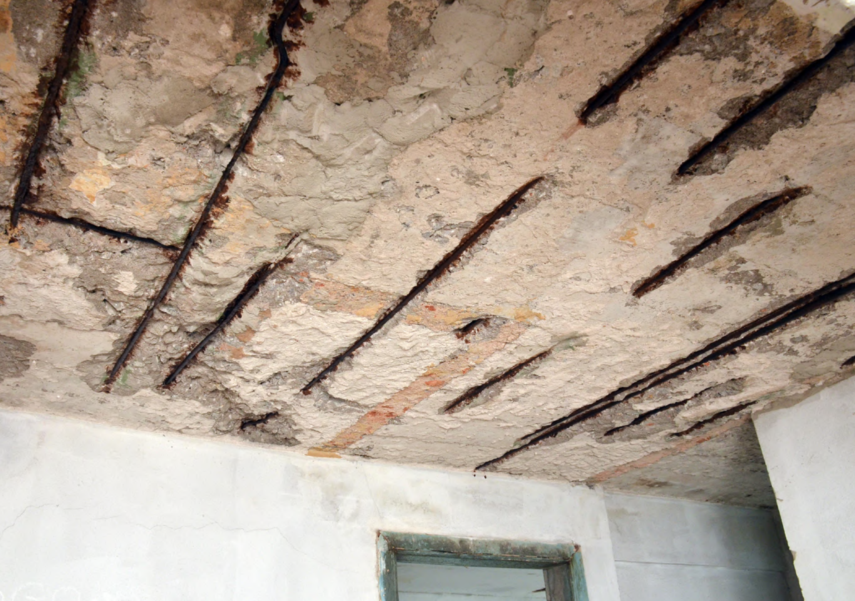
Sala com Necessidade de Reforço Estrutural
