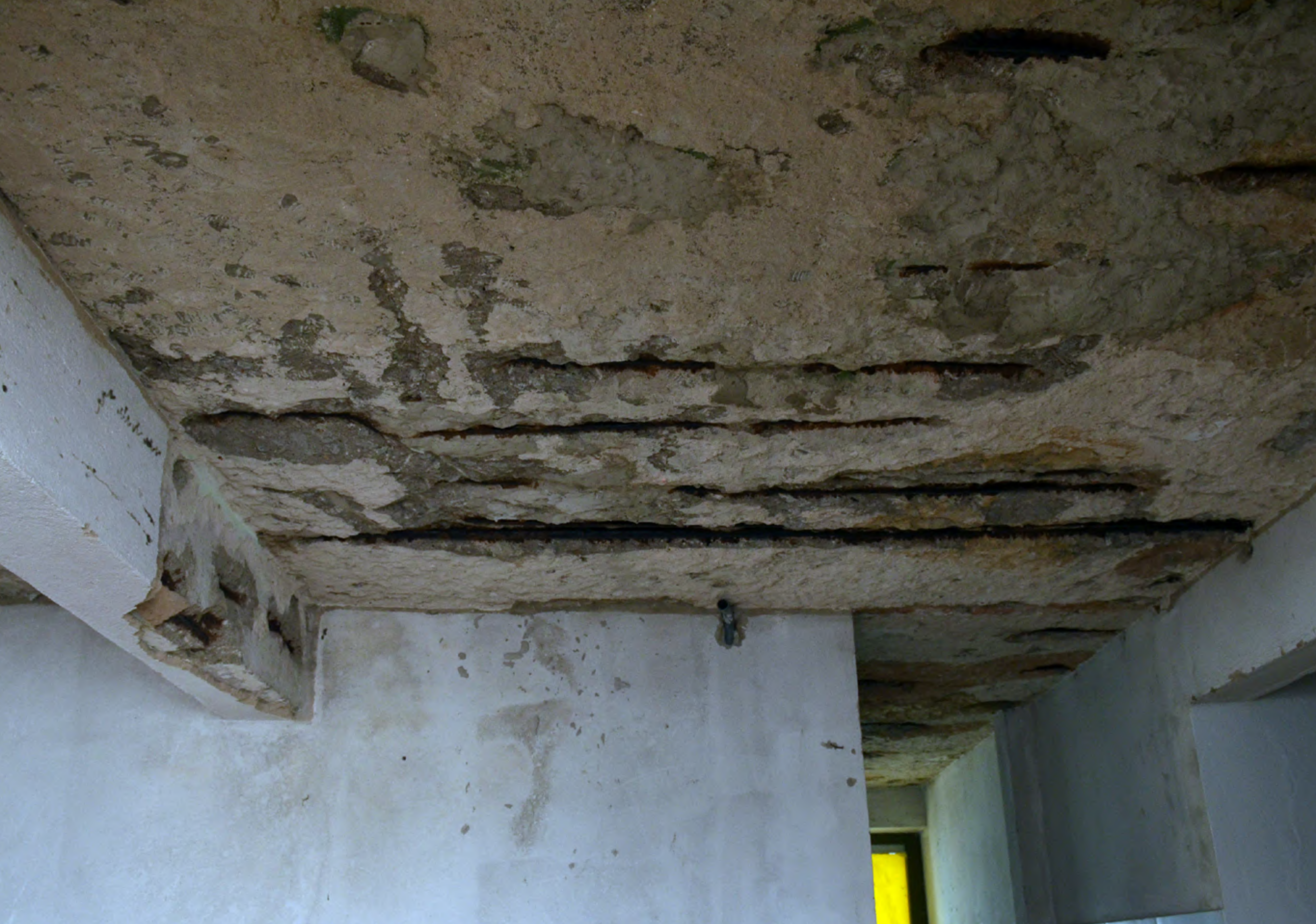
Sala com Necessidade de Reforço Estrutural
