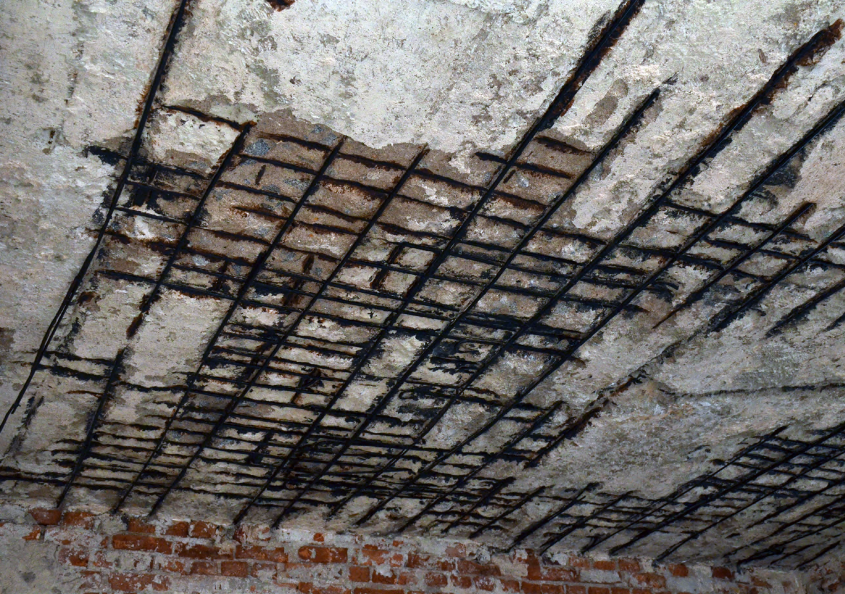
Sala com Necessidade de Reforço Estrutural
